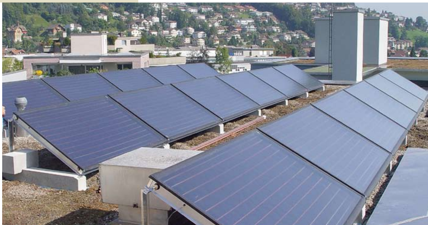
Förderprojekt: Thermische Solaranlage Fenkernstrasse in Kriens.
